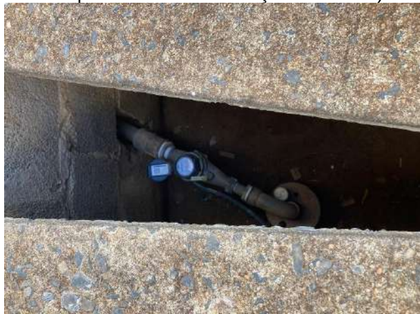
Figura 18: Poço tubular nº 3 (outorga indeferida e com pedido de reconsideração em aberto).
