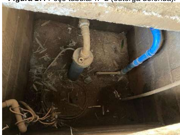
Figura 17: Poço tubular nº 2 (outorga deferida).
