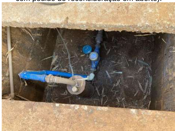
Figura 16: Poço tubular nº 1 (outorga indeferida e com pedido de reconsideração em aberto).
