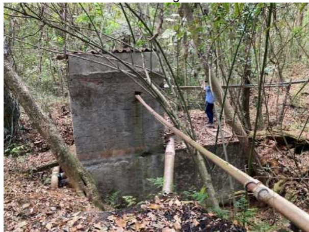
Figura 15: Ponto de captação de água em nascente do Córrego dos Patos.
